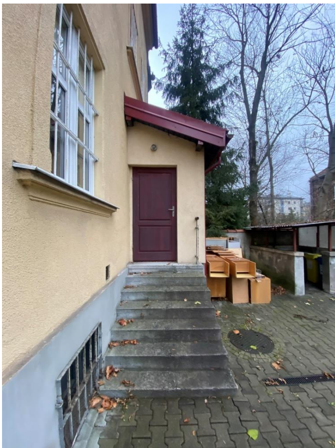
widok ogólny elewacji budynku z dostawionym od pn-zachodu gankiem z mocno zabrudzonymi schodami wykonanymi z betonu i z pierwszym stopniem (przy drzwiach) z szarego lastryka; współczesne jednoskrzydłowe drzwi
